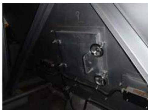
バグフィルタの点検口
